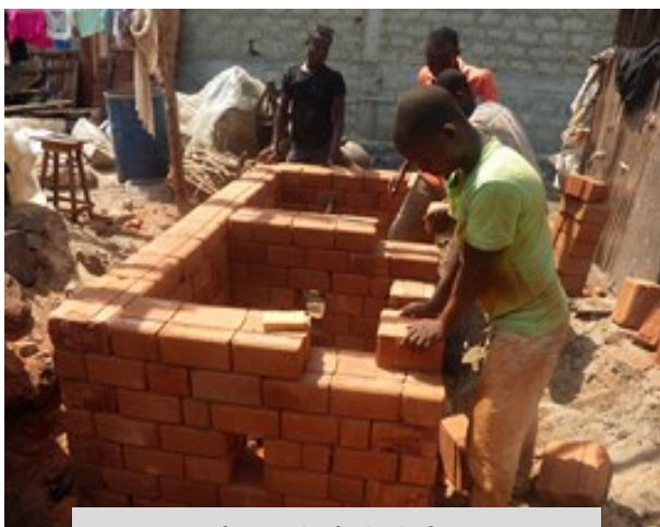
Aération latérale du four
